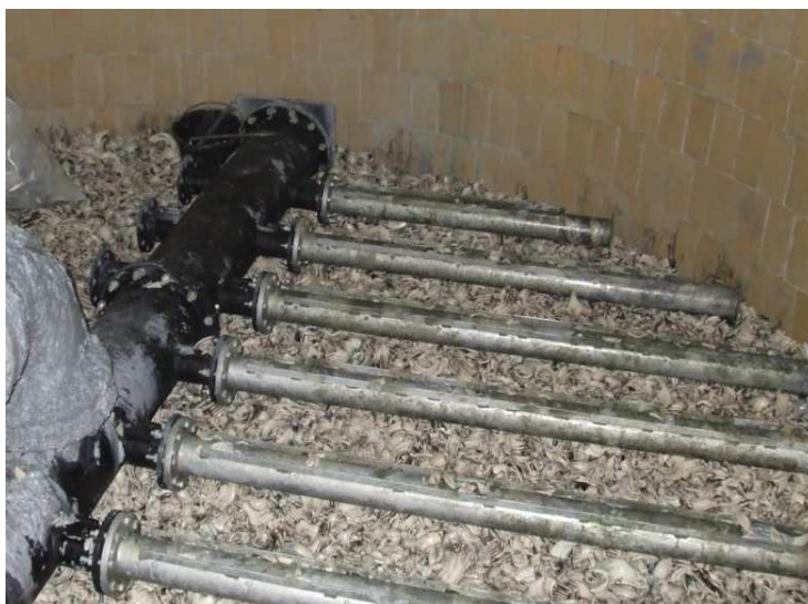
Nuevos riegos instalados en las torres de absorción.
