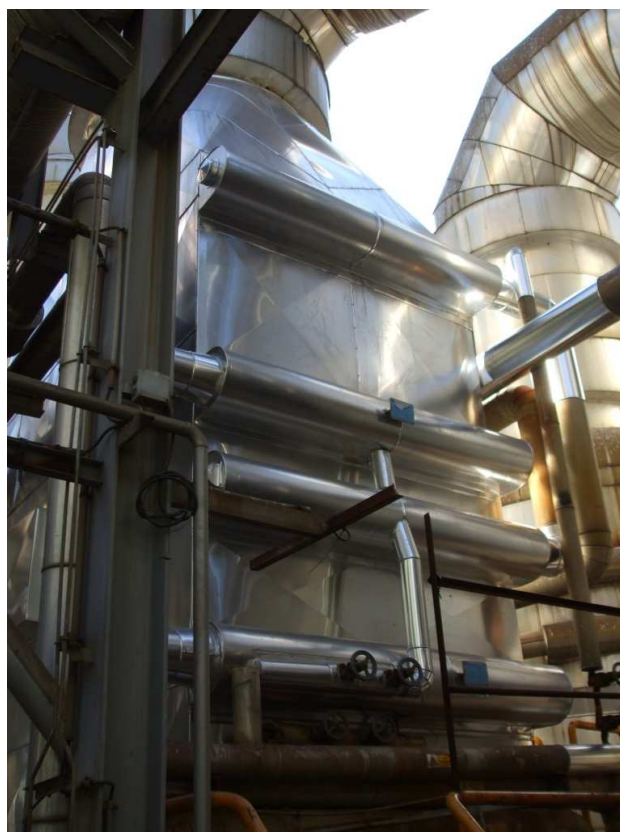
Nuevo economizador E-340.
